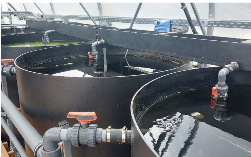
Aquakulturtanks mit Oberflächen- und Bodenabzug
